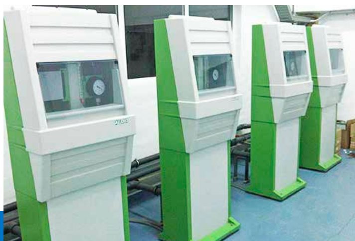
Instal·lació de Dosificació de Clor Gas
