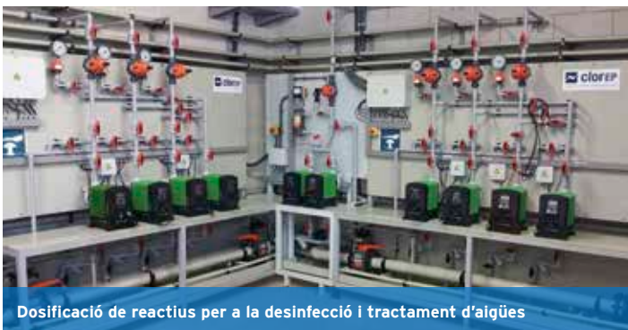
Instal·lacions d'Electrocloració Salina
