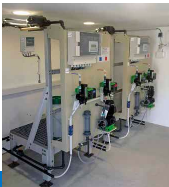
Generadors de Diòxid de Clor
